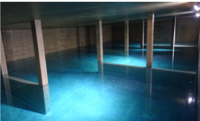
Blick in den Hochbehälter HB6000
